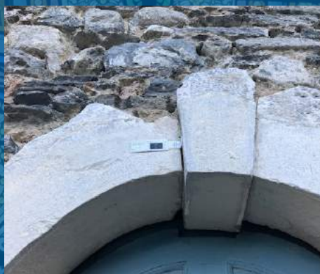
Une jauge à l'église de La Perrière, permettant de mesurer les mouvements
