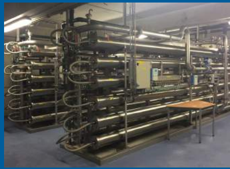
Structure de nanofiltration
